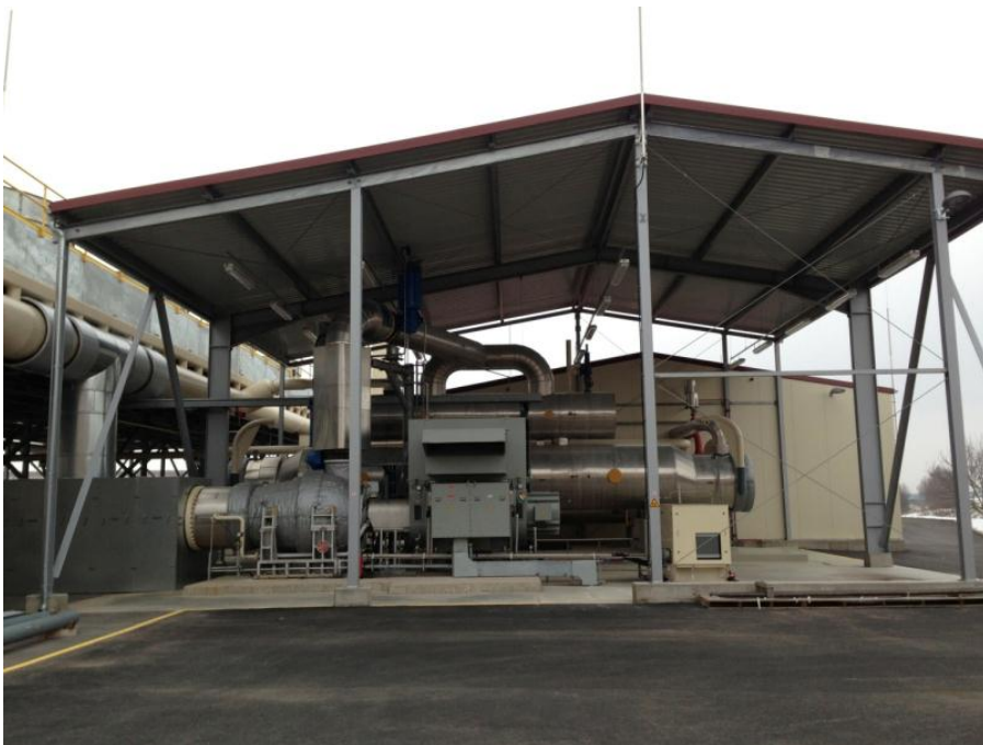
Figura 7. Planta de proceso ORC (Organic Rankine Cycle) en Insheim: turbina y generador. Al fondo, intercambiador de calor tubular y evaporador.
